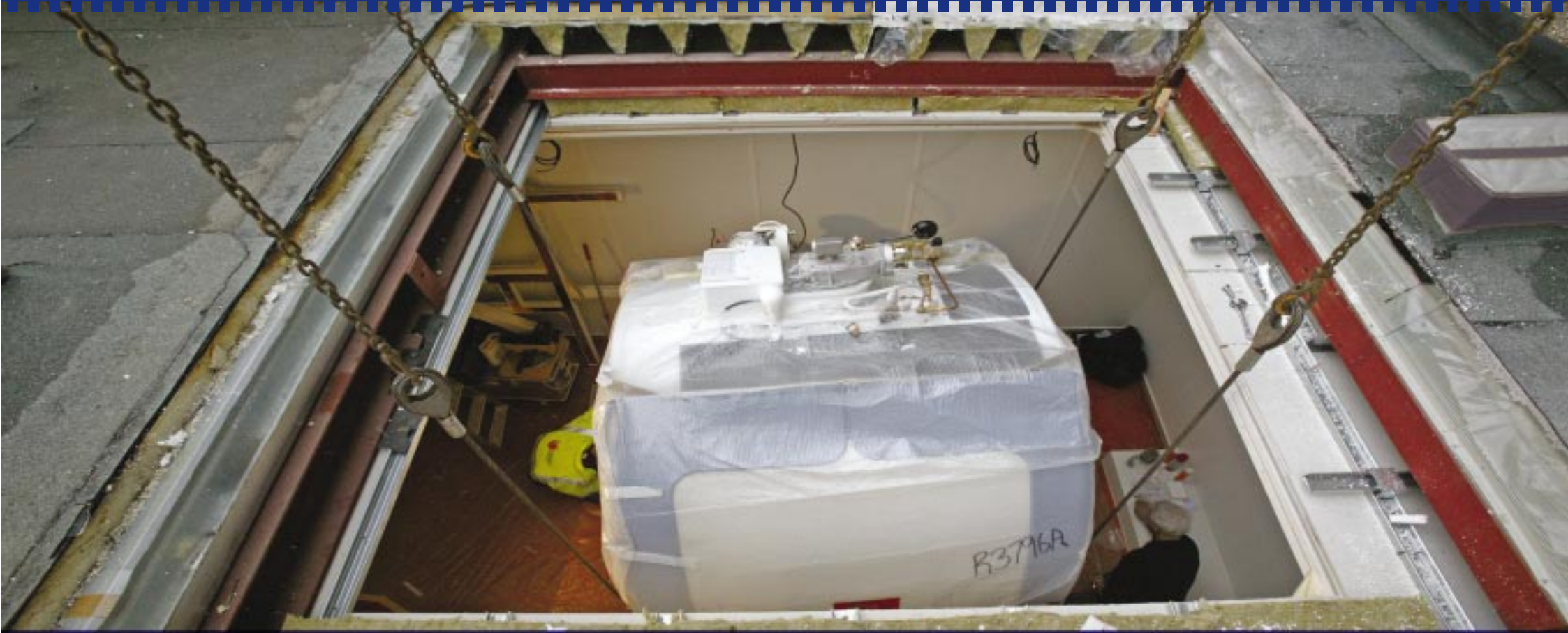
Op 24 februari werd de gloednieuwe MRI-scanner via het dak in het Gezondheidscentrum gehesen.
